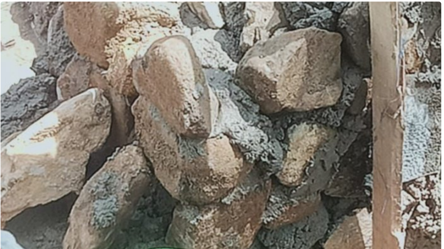
Material Batu Kali Dipaksakan Terpasang Pada Proyek Pekerjaan Irigasi Cipining Desa Cigorondong
