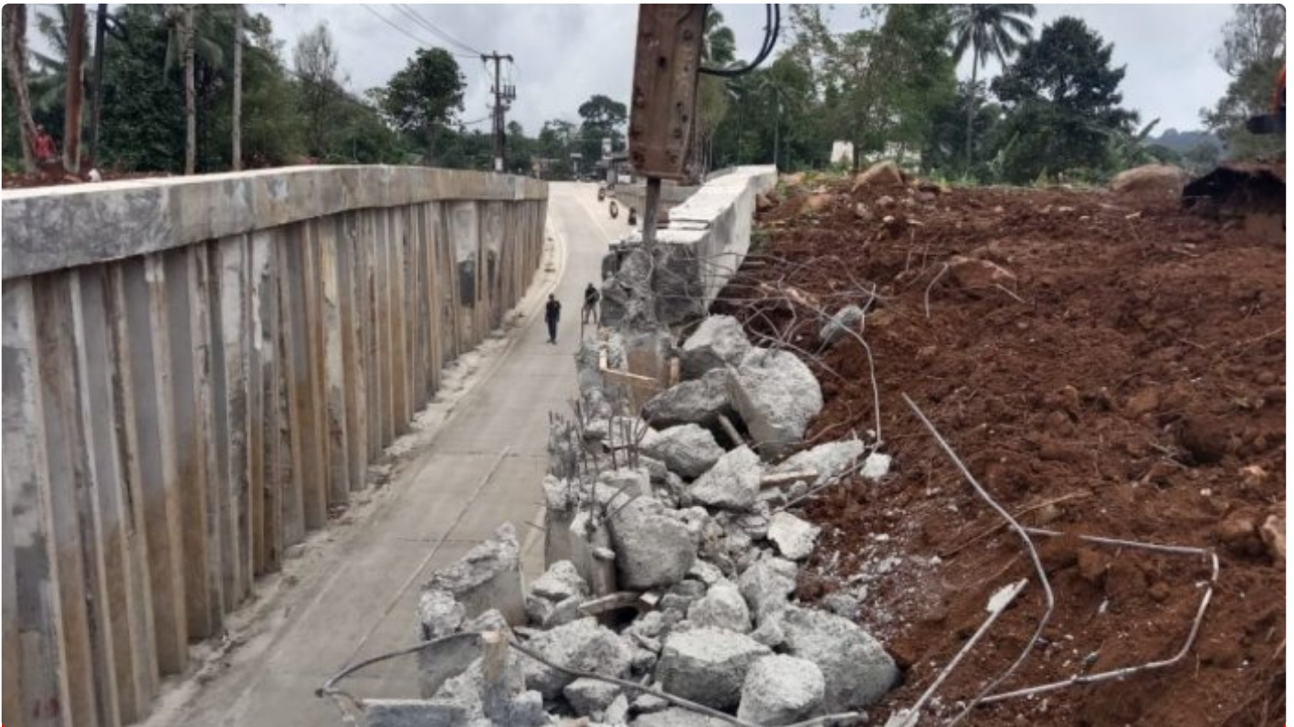
Diduga Proyek Gagal Kontruksi
